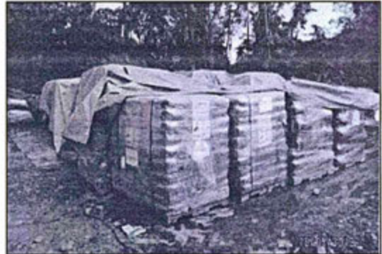
Figura N° 37. En el registro fotográfico se evidencia el almacenamiento de productos químicos sólidos (Sustrafol) expuestas al ambiente. Ubicación: Campamento Base Malvinas.
