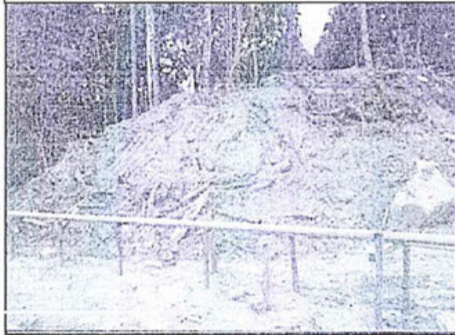
Fotografía N° 4: Inadecuado conservador de topsoil
