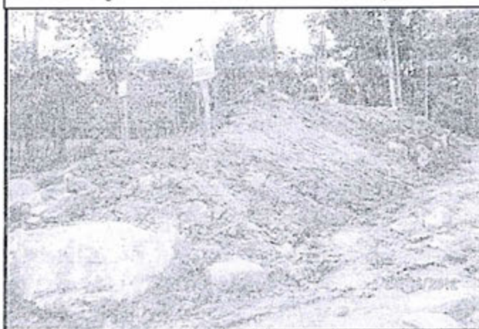
Fotografía N° 5: Inadecuado conservador de topsoil
