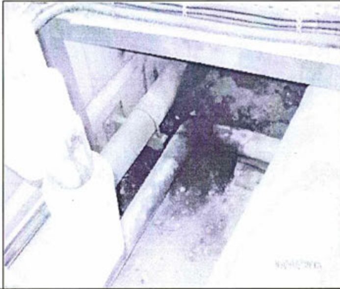
Foto N° 5 Nueva Unidad de Tanques- Piso impregnado con hidrocarburo en el área estanca en un área aprox de 2 x 2 m, debajo de la válvula de ingreso al tanque 304-A .
