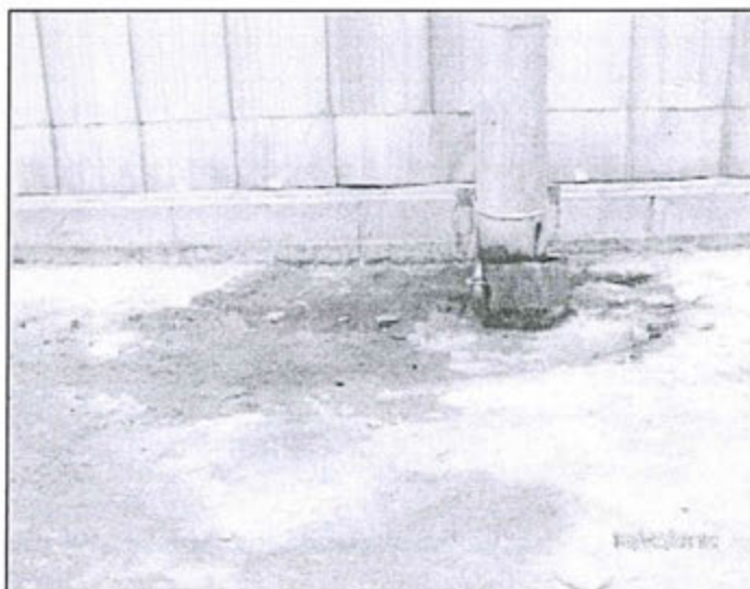
Foto N° 4 Nueva Unidad de Tanques Piso impregnado con hidrocarburo en un área aprox. De 2.5 X 2 m. en el área estanca, alrededor de la bandeja de contención, ubicada debajo del tubo de venteo del Tanque 303 de crudo reducido. Además la bandeja se encuentra deteriorada (tiene huecos)
