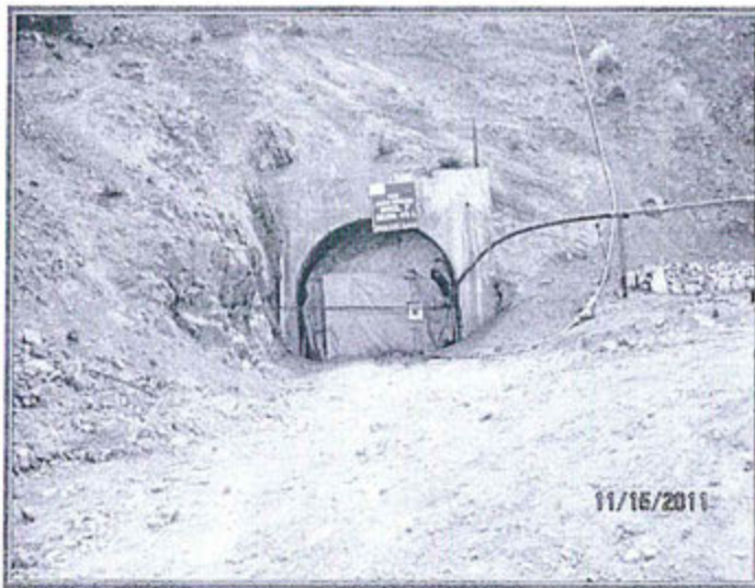
FOTOGRAFIA N° 304.- Vista fotográfica del Nv. 7 Santa Catalina, usado como servicios para ventilación e ingreso de la tubería de aire comprimido.
