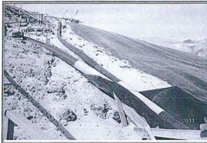
FOTOGRAFIA N° 40.- Observación N° 03: La tubería de conducción de relaves, en el tramo de llegada a la parte superior del dique de contención, falta completar el canal de contingencias.
