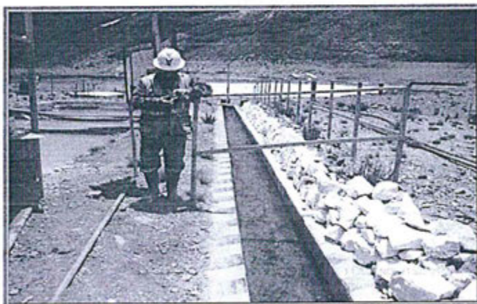
FOTOGRAFIA N° 23.- Proyecto PAMA N° 09: El agua de mina del Nivel 12 Pumahuasi (efluente E - 2), a través de un canal de concreto es vertido directamente al Río Santiago sin ningún tratamiento. Antes de la descarga al río al río es mezclado con la descarga del agua tratada de la bocamina del Nivel 12 Veta Bateas.
