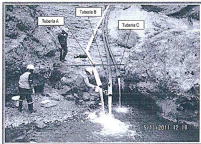
FOTOGRAFÍA N° 83.- Muestreo en la descarga de las tuberías, codificados como E - 5A, E - 5B, E - 5C: Vista fotográfica de los muestreos realizados de las descargas de las tres tuberías procedentes del efluente E - 5. De la descarga de las tuberías A, B y C se obtuvieron las muestras codificadas en campo como E - 5A, E - 5B y E - 5C respectivamente.
