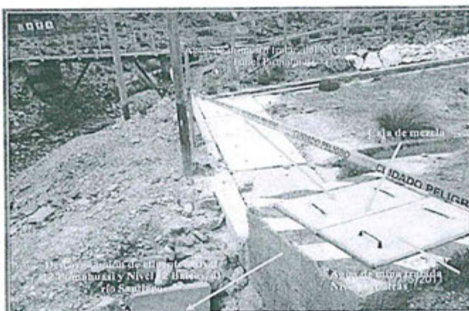
FOTOGRAFIA N° 153.- Descarga de agua de mina Tratada del Nivel 12 Veta Bateas: Caja donde se mezcla el agua tratada del Nivel 12 Veta Bateas con el agua de mina sin tratamiento del Nivel 12 Pumahuasi.
