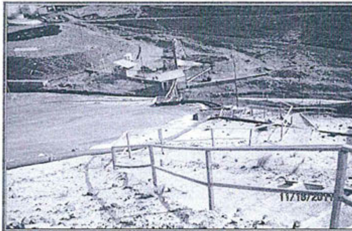
FOTOGRAFIA N° 41.- Observación N° 03: La tubería de conducción de relaves, en el tramo de llegada a la parte superior del dique de contención, falta completar el canal de contingencias.
