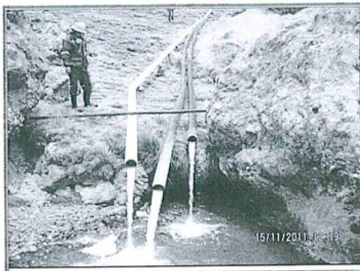
FOTOGRAFIA N° 149.- Descarga del agua de mina Nivel 12 Veta San Cristóbal: Descarga al río Santiago, del agua de mina tratada del Nivel 12 Veta San Cristóbal, por medio de tres tuberías de 4" de diámetro.
