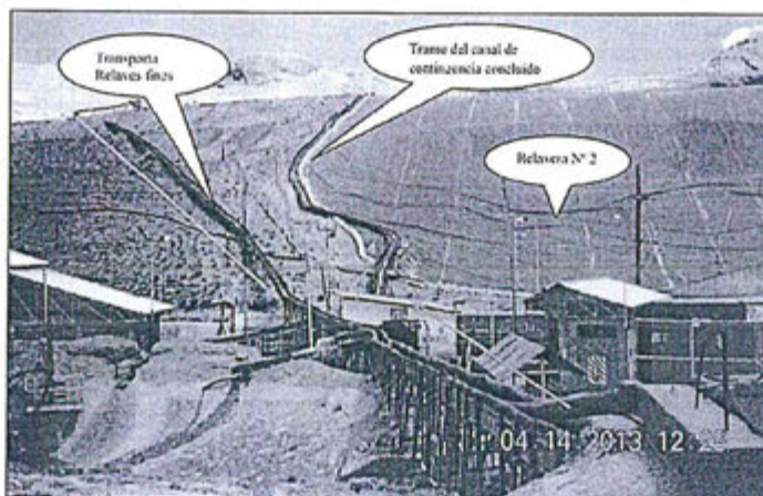
Fotografía N° 35. Transporte de relaves desde la planta de beneficio, mediante tuberías HDPE de 6" hacia el depósito de relaves N° 2, con el sistema de bombeo de la caseta de bombeo antigua.
