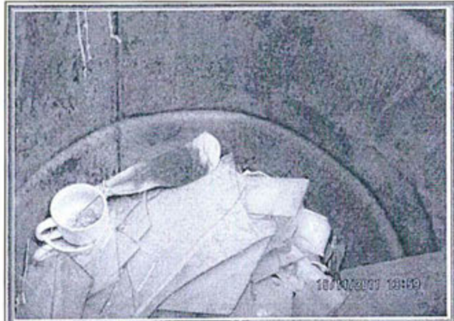
FOTOGRAFÍA N° 59.- Observación N° 08: Vista fotográfica del interior del cilindro verde (para la disposición de residuos de vidrios) instalado en zona Bateas (coordenada UTM WGS 84: 8°319,578N; 192,349E y 4539 msnm), se aprecian otros residuos (taza de porcelana y botella de plástico impregnado con hidrocarburos) que no corresponden al tipo indicado.
