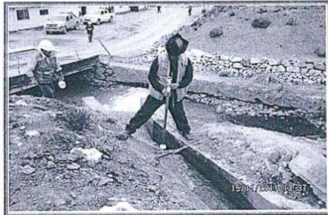
FOTOGRAFÍA N° 88.- Punto de control E – 03: Vista fotográfica en el que se aprecia la toma medición de caudal, en la descarga del efluente E – 03 (unión de efluentes Pumahuasi y Bateas) hacia el río Santiago.
