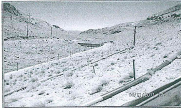
FOTOGRAFÍA N° 185.- Evaluación de peligros y riesgos del sistema de conducción de relaves: Tubería de PVC, con empalmes de bridas, por rotura y/o desempalme, producirá derrames de relaves que podrían llegar al cauce del río Santiago. Observación N° 03.
