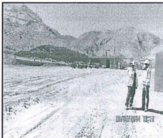
Fotografía 4: Se observa el proyecto de "Línea de Transmisión" que se encuentra en la fase de construcción.
