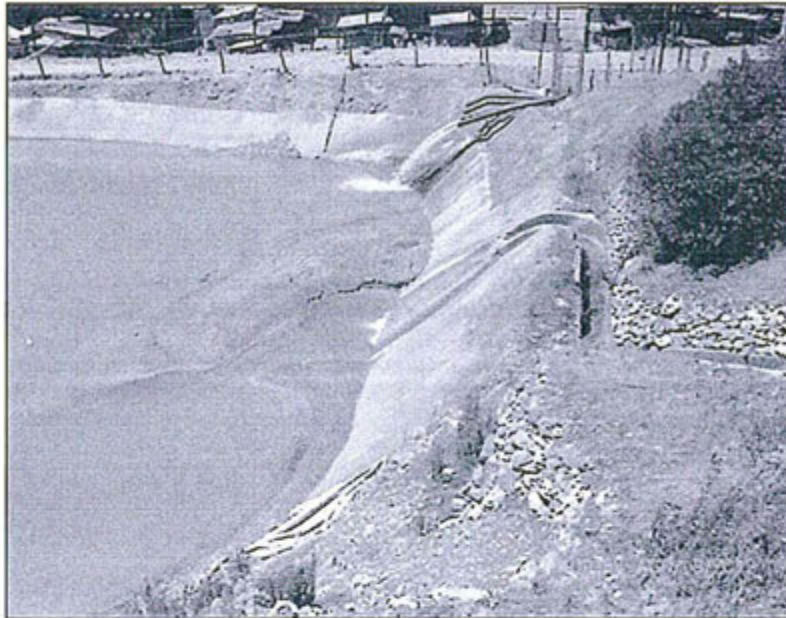
Foto N° 9: Poza de sedimentación N° 2 operativa con presencia de sólidos sedimentables por falta de limpieza. (Observación N° 02)
