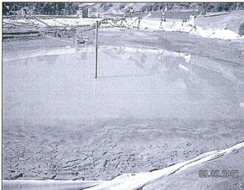
Foto N° 7: Poza de sedimentación N° 1 inoperativa y en condiciones inadecuadas de impermeabilización (Observación N° 01)
