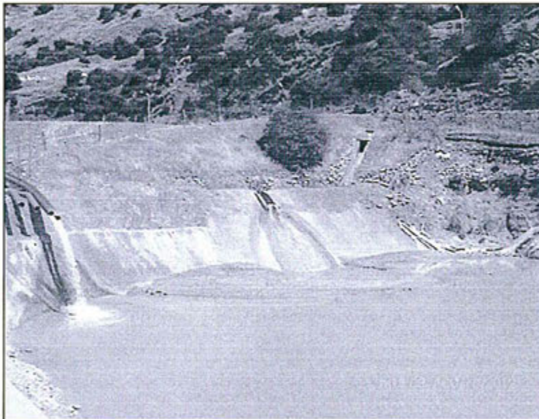
Foto N° 10: Otra vista de la poza de sedimentación N° 2 con sólidos que requieren ser limpiados para asegurar tratamiento del efluente vertido (Observación N° 02)
