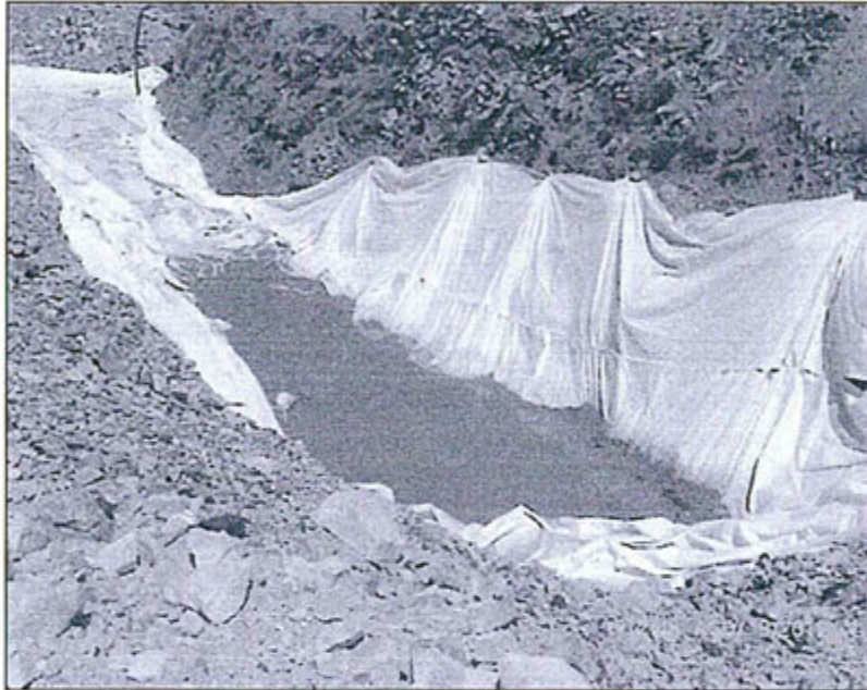
Foto N° 18: Disposición inadecuada en la desmontera La Quinua de los sólidos limpiados por bombeo desde las pozas de tratamiento. (Observación N° 03)
