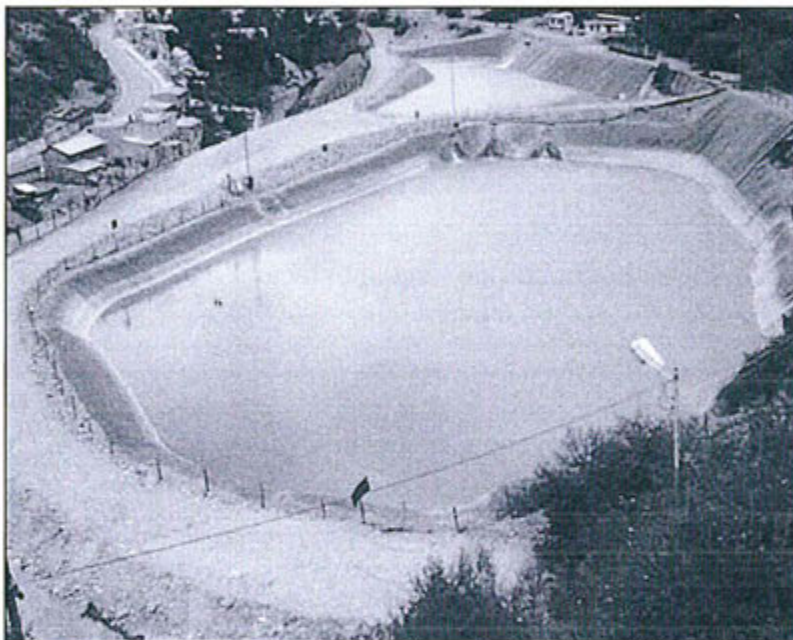
Fotografía N° 1: Vista actual de la poza de sedimentación N° 1. Nivel – 450, La Quinua. EN LA FOTOGRAFÍA SE PUEDE OBSERVAR CLARAMENTE LA IMPERMEABILIZACIÓN DE ESTA INFRAESTRUCTURA CON GEOMEMBRANA
