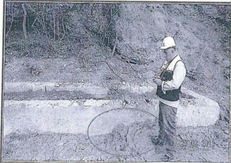
Fotografía N° 26: Área de lavado y poza de sedimentación de vehículos livianos suelos naturales adyacentes con presencia de residuos de hidrocarburos produciendo impacto negativo. Hallazgo N° 16 – Supervisión Ambiental 2013.
