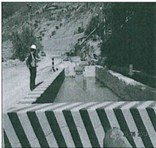
Foto N°3: Poza de contención de lodos generados en la tercera etapa de sedimentación
