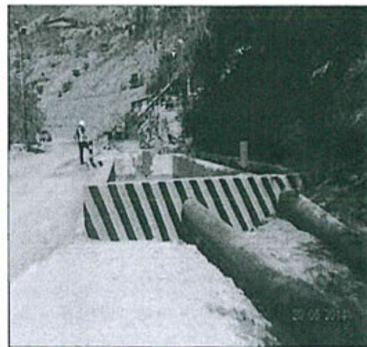
Foto N°4: Poza de contención de lodos generados en la tercera etapa de sedimentación
