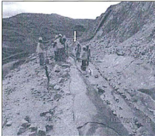
Foto N° 4. Observación N° 2 Supervisión 2011: Canal de coronación de los Pad de lixiviación entre las coordenadas UTM WGS-84 E821562 N 9 116753 al E 821435 N 9 116855 sin geomembrana.
