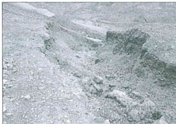
Foto N° 23.- Observación N° 9. Supervisión 2011: Cárcavas provocadas por erosión hidráulica, ubicado en la parte oeste del depósito de desmontes Suro Norte.
