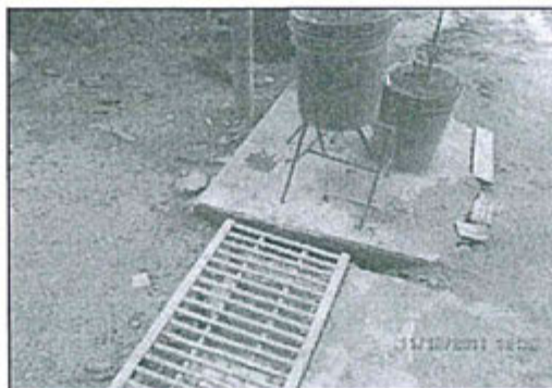
Foto N° 45.- Incumplimiento observación N° 8, Supervisión 2010: La vista muestra que la canaleta de colección existente ha sido empalmada hacia una trampa de grasa; sin embargo, el lado izquierdo de la canaleta está sobre suelo natural y la infraestructura de colección o trampa de aceites no presenta un diseño ingenieril que permita el cumplimiento medioambiental.
