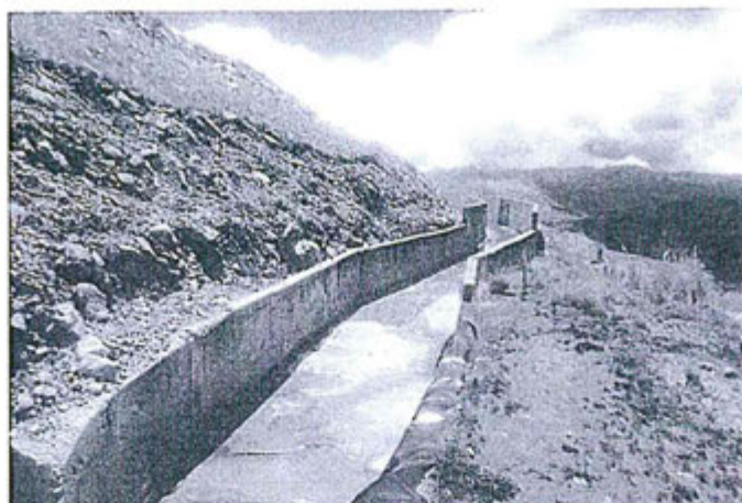
VISTA FOTOGRÁFICA DEL TRAMO FINAL DEL CANAL DE CORONACIÓN QUE DERIVA LAS AGUAS DE LLUVIA HACIA LA QUEBRADA TRES CRUCES
