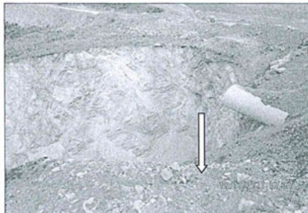
Foto N° 8.- Observación N° 2. Supervisión 2011. Tubería de descarga de las aguas de escorrentía del canal de coronación de los PAD de lixiviación a la quebrada Tres Cruces, en las coordenadas WGS- 84 E 820 691 N 9 116 592. Nótese la altura (aprox. 20 m.) y la fuerte erosión ocasionada.
