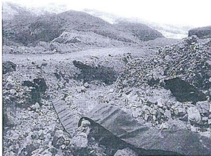
VISTA FOTOGRÁFICA DE LA DESCARGA DE LAS AGUAS DE LLUVIA HACIA LA QUEBRADA TRES CRUCES
