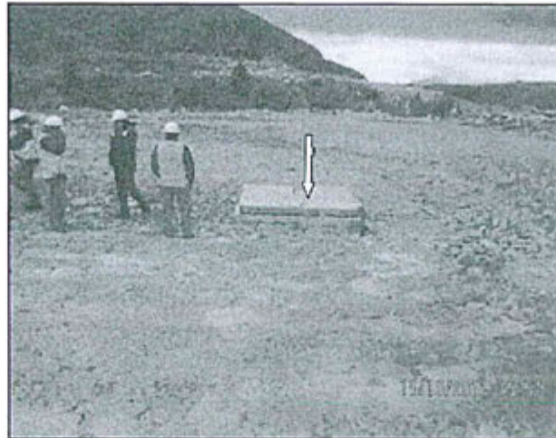
Foto N° 51.- Incumplimiento N° 12. Supervisión Regular 2010: Poza de lixiviados del relleno sanitario, sin presencia de agua; pero no se evidencia un diseño ingenieril que evite posteriores inundaciones.
