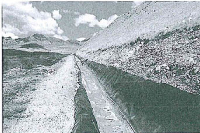
VISTA FOTOGRÁFICA DEL CANAL DE CORONACION QUE DERIVA LAS AGUAS DE LLUVIA HACIA LA QUEBRADA TRES CRUCES
