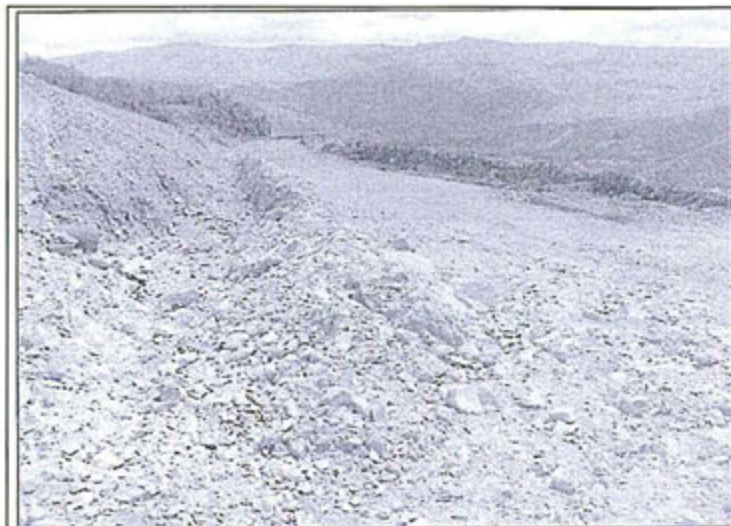
Fotografía N° 06. Vista del botadero Suro Norte, donde se encontraron zonas menores con erosiones contiguo a la vía de acceso por el lado oeste.
