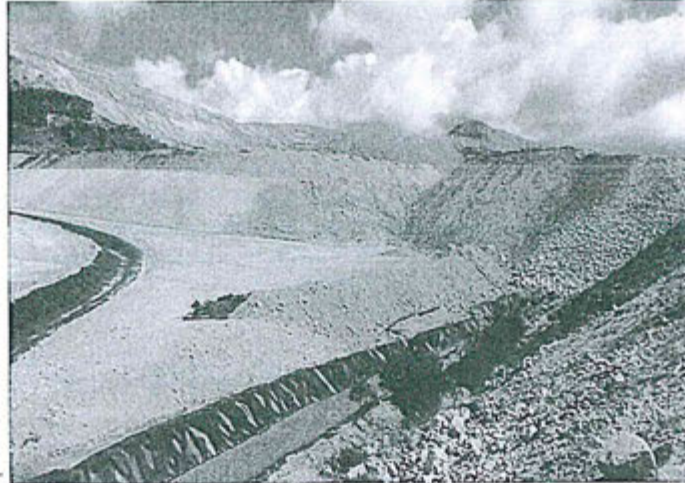
VISTA FOTOGRÁFICA DEL CANAL DE CORONACION QUE DERIVA LAS AGUAS DE LLUVIA HACIA LA QUEBRADA TRES CRUCES
