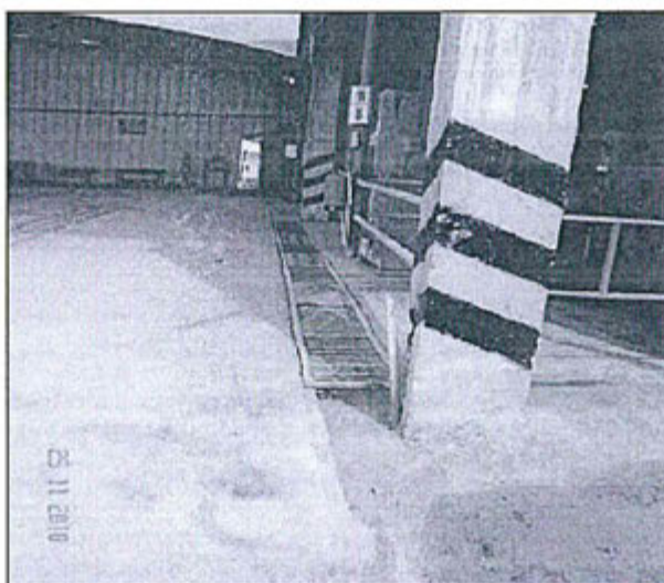
Foto 2.10 Obs. 8. En el taller de mantenimiento existen canaletas sobre piso de concreto con salida directa al ambiente (suelo natural).
