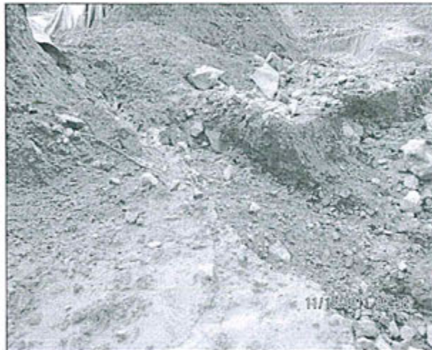
Fotografía N° 6: Observación N° 2 Supervisión 2011: Cárcava, ubicado al costado de la poza de sedimentación que capta las aguas del canal de coronación de los PADs de lixiviación (coordenadas UTM WGS-84E: 820 799N: 9116510). La poza de sedimentación no se observa porque se encuentra en la parte superior izquierda la vista fotográfica (en la foto N° 5 se observa la poza de sedimentación).
