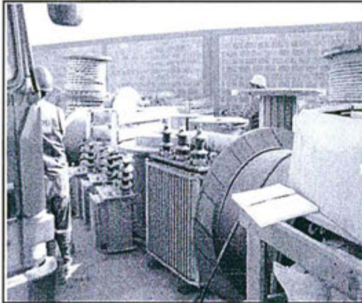
Fotografía N° 5: Almacén temporal de residuos sólidos peligrosos y no peligrosos sin pisos impermeabilizados, sin sistema de contención, sin cerco perimétrico ni sistema contra incendios.
