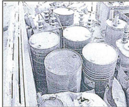
Fotografía N° 22: Cilindros con aceite usado sin sistema de contención, ni sistema de drenaje ni rótulos de identificación.
