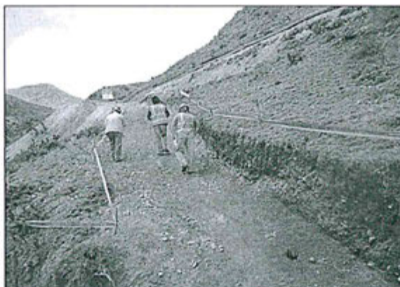
Fotografía N° 12 del Informe de Supervisión: Camino de acceso a la Plataforma de perforación diamantina DDH-LY-07, que no cuenta con cunetas para el drenaje de las aguas de escorrentía.
