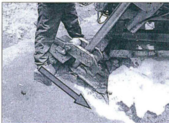
Fotografía N° 14 del Informe de Supervisión: Otra vista del canal de salida de agua y poza de regulación del taladro de perforación diamantina, en la Plataforma DDH-LY-07, que no se encuentran impermeabilizadas mediante geomembrana.
