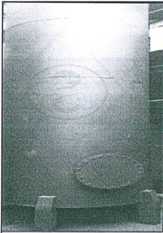
Vista del tanque de retención implementado
