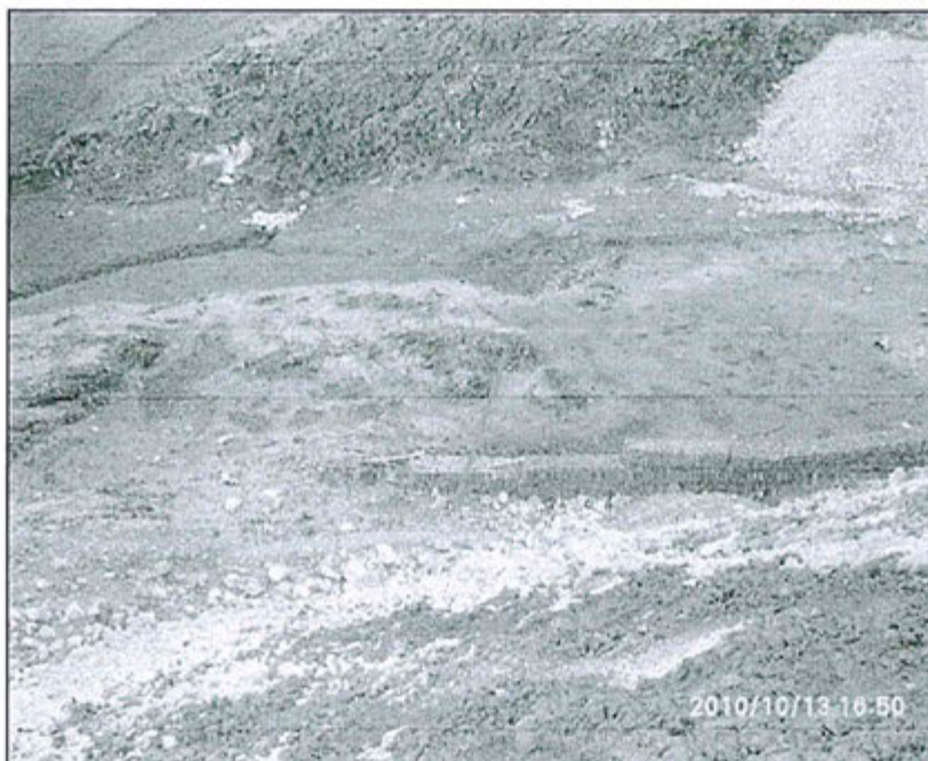
Fotografía N° 5.- Se observa rocas que caen por la pendiente del talud, pasan hacia el área de pastizal por falta de empalme del muro de contención en la base del talud del botadero de desmonte del Nv. 130. Se debe
