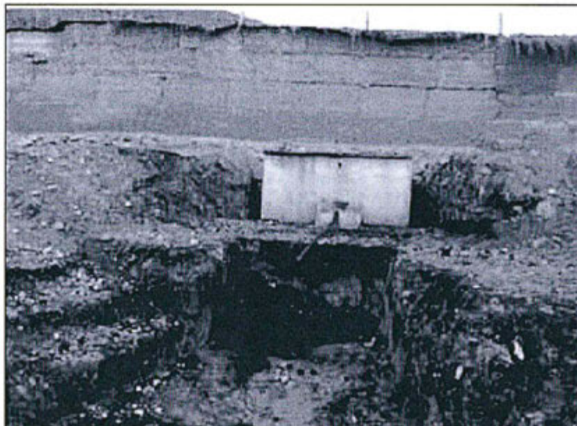
Caja de captación de agua de lixiviación
