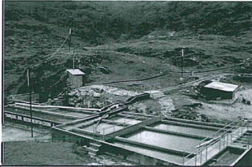
Tanque de sedimentación de solidos (lodos)
