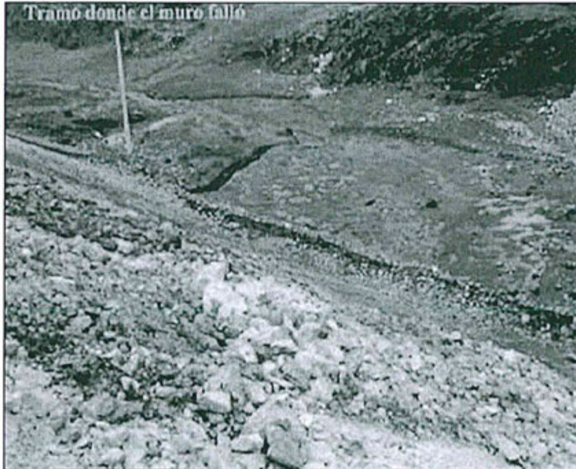
FOTOGRAFÍA N° 48.- Recomendación N° 5, botadero de desmonte nivel 130: Un tramo de 15 m del muro de contención falló, el desmonte está pasando al pastizal.
