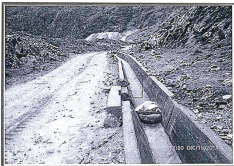
FOTOGRAFÍA N° 70.- Observación N° 19: El efluente de agua del Nv. 130 Haswuz (paralizado) es desviado por la alcantarilla, no sigue el curso normal hacia la poza de tratamiento de agua de mina del Nv. 105
