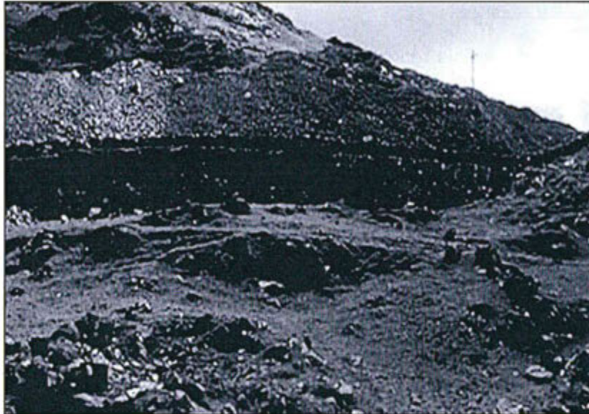
Nivelación de empalme de gaviones como muro en la desmontera del Nivel 130
