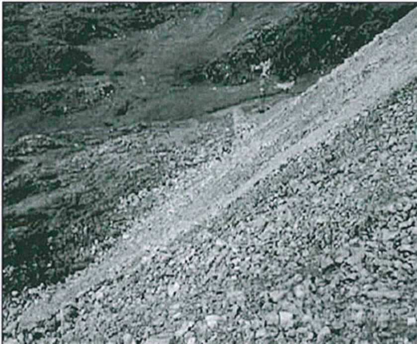
FOTOGRAFÍA N° 49.- Recomendación N° 5, botadero de desmonte nivel 130: Un tramo de 80 m el muro quedó enterrado, el desmonte está pasando al pastizal.
