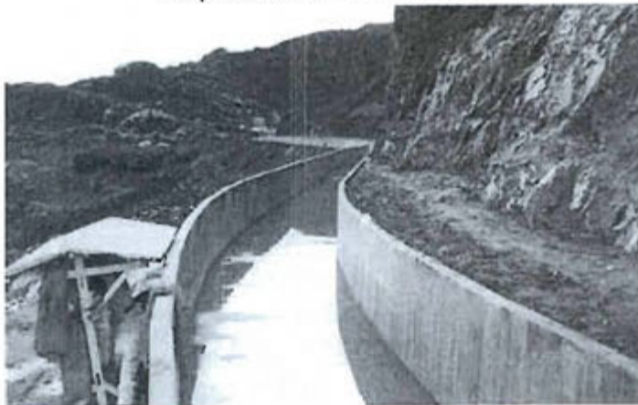
Fotografía 3. Sub-sistema colector de la Margen Izquierda de la Ampliación del Botadero Este
