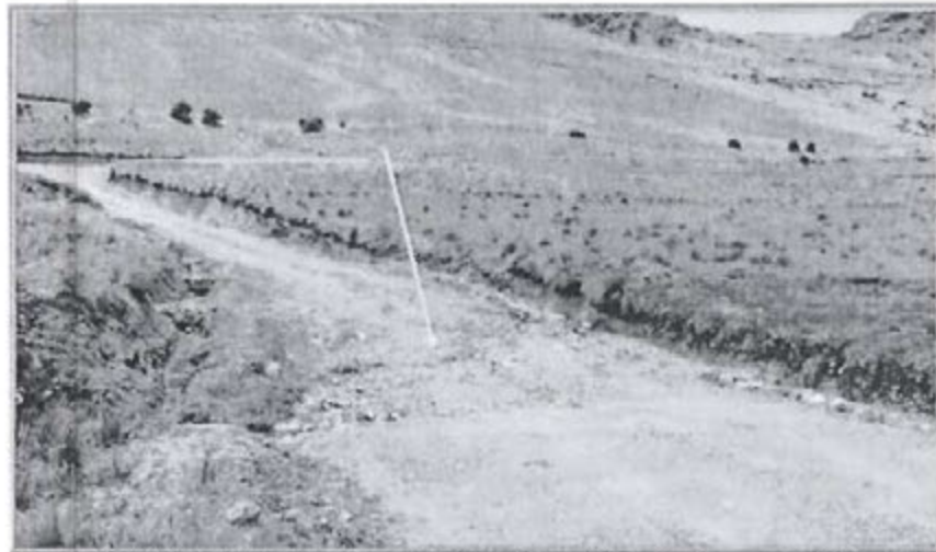
Fotografía N° 29: Recomendación N° 5. Vista fotográfica donde se constata que en el cruce a la carretera por el agua escorrentía colectada por el canal, el titular minero no construyó el badén
