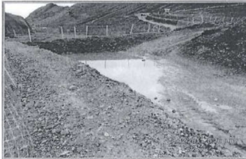
Fotografía N° 67: Observación N° 01. Relleno Sanitario: Se constató en la entrada al relleno sanitario, acumulación de agua por un mal sistema de colección y recuperación de aguas en su interior
