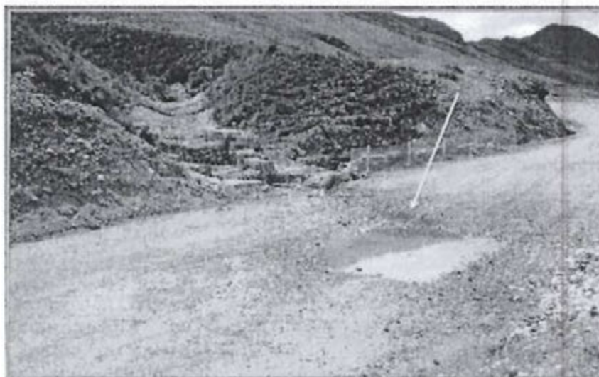
Fotografía N° 28: Recomendación N°5. Vista fotográfica donde se constata que en el cruce a la carretera por el agua escorrentía colectada por el canal, el titular minero no construyó el badén.
