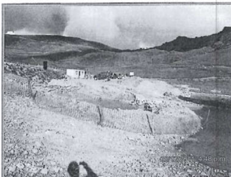
Fotografía N° 185: Observación N° 8. En las pozas de sedimentación y costados de los canales de escorrentía - costado Estación Bravo 4 se observó, suelos disturbados. Las lluvias producen arrastre de sólidos al cauce de aguas de lluvia. Impacto Ambiental: Impactando al medio natural (Suelo)
