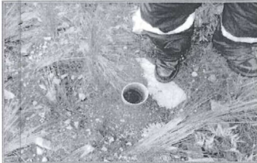
Fotografía N° 17: Recomendación N° 3. En la zona Campamento se constató un segundo taladro diamantino que no está taponeado
