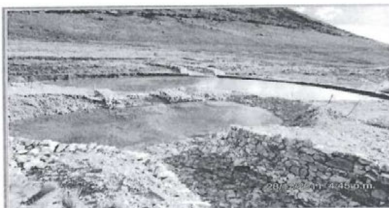
Fotografía N° 160: Recomendación N° 10. El titular minero construyó pozas de neutralización y sedimentación para la modificación del pH de las aguas colectadas
