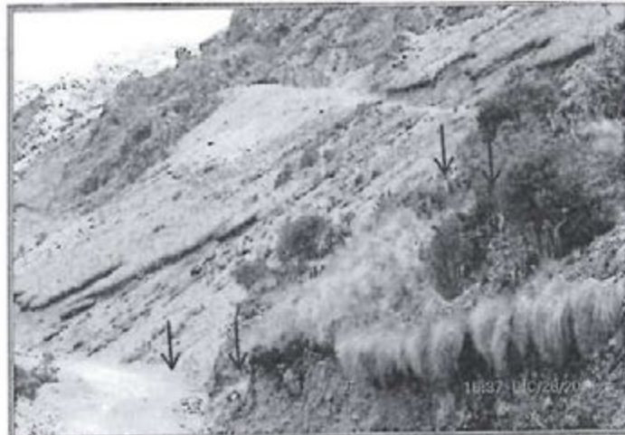
Fotografía N° 159: Observación N° 3. Talud de suelo natural sobre la carretera hacia la Laguna Rinconada, erosionada por la escorrentía de agua de canal de coronación de la carretera superior
