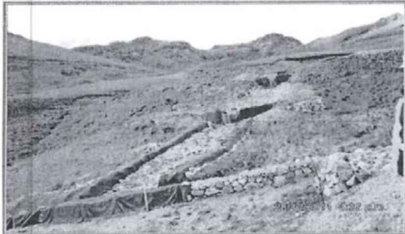
Fotografía N° 56: Recomendación N° 11. Parte alta zona de Chancas, se constató la construcción de pozas de neutralización para el control de pH y retención de sólidos, los canales son revestidos con un enrocado para evitar la erosión y el arrastre de sólidos.
