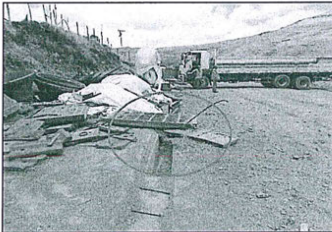
Fotografía N° 66 del Informe de Supervisión: "(...) En el Nv. +80, depósito de tránsito N° 1 de residuos industriales, en las coordenadas UTM WGS-84 8'827 689N, 367 777E, otra vista de la obstrucción del canal de captación de aguas de escorrentía en otro tramo, se observan chatarras dispuestos en el canal."
