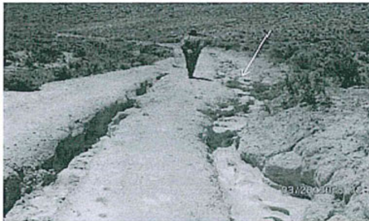
Fotos N° 10 y 12: Vía de acceso hacia las plataformas se observó la falta de cunetas, la falta de remediación de los mencionados accesos y el deterioro por causa de las precipitaciones pluviales.
