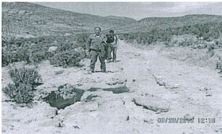
Foto N° 11: Camino de acceso al Proyecto Susapaya deteriorado por las precipitaciones pluviales.
