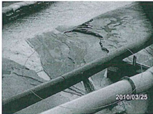
Fotografía N° 86 del informe de supervisión del año 2010: Rotura de la tubería de conducción de relaves hacia la presa de relaves Ocroyoc, aguas abajo del canal de coronación de la margen izquierda, no se observa sistema de contingencia, UEA Cerro de Pasco.
