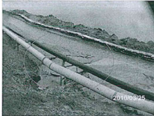
Fotografía N° 85 del informe de supervisión del año 2010: Rotura de la tubería de conducción de relaves hacia la presa de relaves Ocroyoc, aguas abajo del canal de coronación de la margen izquierda, no se observa sistema de contingencia, UEA Cerro de Pasco.
