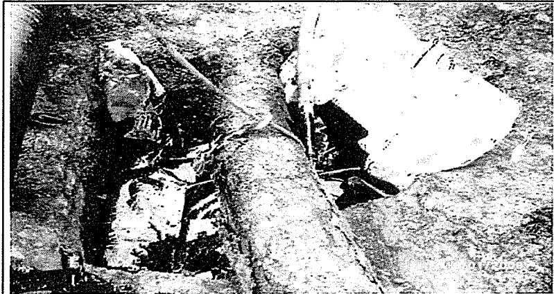
Foto N° 7. Lote 1 AB -Jibarito.- Punto del derrame, se colocó sobre la poza de tierra una cubierta impermeable.
