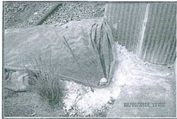
FOTOGRAFIA N° 119.- En el área de preparación de reactivos de la planta de tratamiento de agua de mina Ticlio se observó que la cal empleada en la preparación de lechada de cal, fue descargada fuera del área de almacenamiento y se encuentra a la intemperie, una parte de ella sobre suelo natural. Observación N° 6 – 2012.
