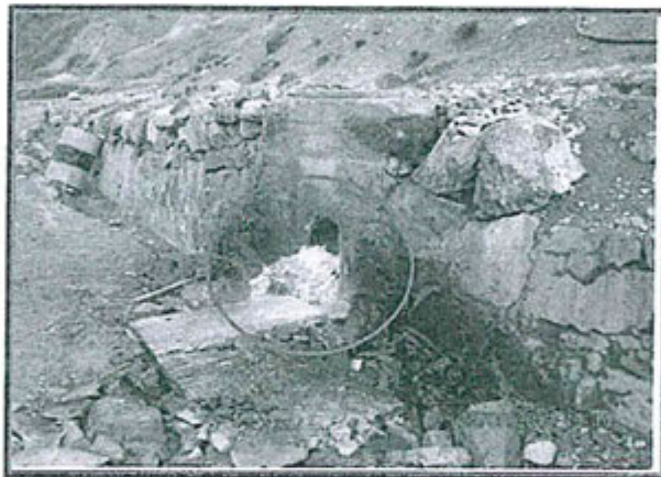
FOTOGRAFIA N° 27.- Se observó que el agua proveniente de la poza de clarificación de la planta de tratamiento de agua de mina Ticlio no está debidamente canalizada hacia la caja de registro. (referencia: cerca a la vía de acceso hacia la planta de tratamiento de agua de mina de Ticlio y vía férrea, con coordenadas UTM WGS 84: 8 716 066 N, 369 750 E y 4 762 msnm). Observación N° 2 - 2012.
