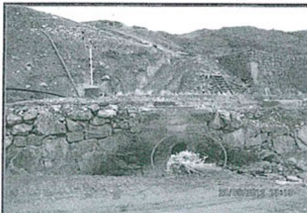
FOTOGRAFIA N° 28.- Se observó que el agua proveniente de la poza de clarificación de la planta de tratamiento de agua de mina Ticlio no está debidamente canalizada hacia la caja de registro. (referencia: cerca a la vía de acceso hacia la planta de tratamiento de agua de mina de Ticlio y vía férrea, con coordenadas UTM WGS 84: 8 716 066 N, 369 750 E y 4 762 msnm). Observación N° 2 - 2012.
