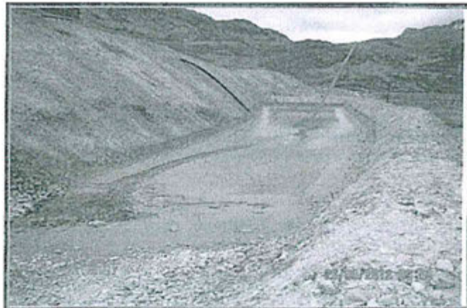
FOTOGRAFIA N° 48.- Vista de la otra poza sobre suelo natural para la disposición de lodos, que forman parte de la planta de tratamiento de aguas de mina zona Huacrachocha. Se aprecian los lodos dispuestos en el interior. Observación N° 8 - 2012.
