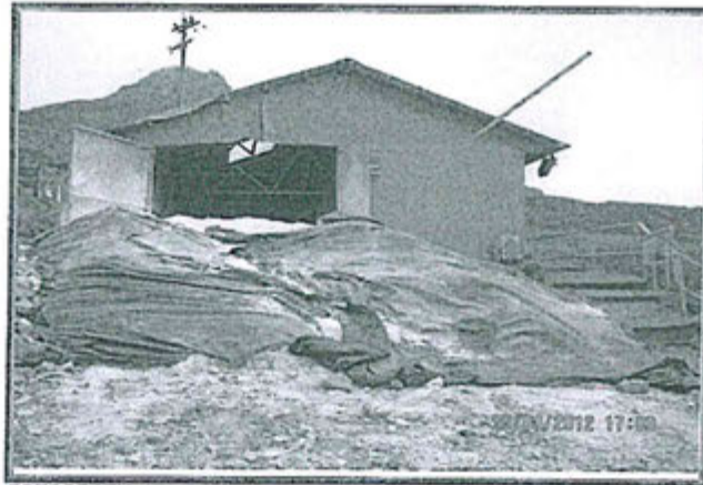
FOTOGRAFIA N° 10.- Se aprecia el área de preparación de reactivos de la planta de tratamiento de agua de mina Ticlio. Se observó que la cal empleada en la preparación de lechada de cal, fue descargada fuera del área de almacenamiento y se encuentra a la intemperie, una parte de ella sobre suelo natural. Observación N° 6 – 2012.
