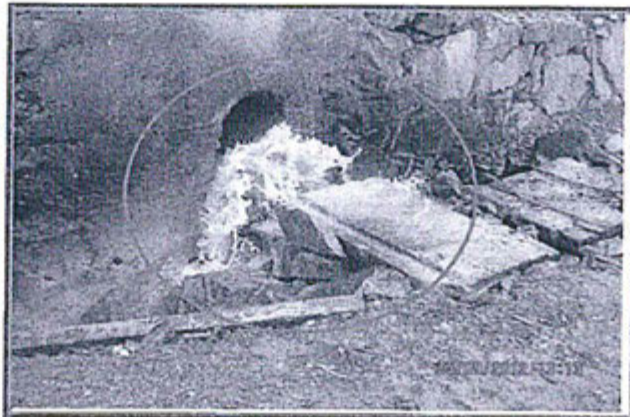
FOTOGRAFIA N° 29.- Se observó que el agua proveniente de la poza de clarificación de la planta de tratamiento de agua de mina Ticlio no está debidamente canalizada hacia la caja de registro. (referencia: cerca a la vía de acceso hacia la planta de tratamiento de agua de mina de Ticlio y vía férrea, con coordenadas UTM WGS 84: 8 716 066 N, 369 750 E y 4 762 msnm). Observación N° 2 - 2012.
