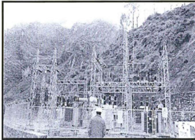
Fotografía N° 12: S.E. Baños IV (Coordenadas UTM 0325119 E, 8759018 N) que aún no se encuentra conectada con la S.E Baños V que es la que generará la energía a transportar a la S.E. Animón a 42,5 kilómetros de distancia
