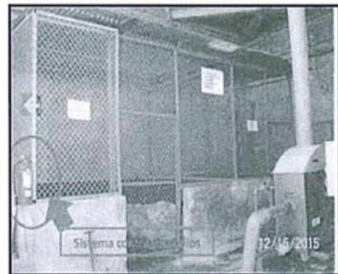
Sistema contra incendios Almacén Central de residuos sólidos peligrosos húmedos
