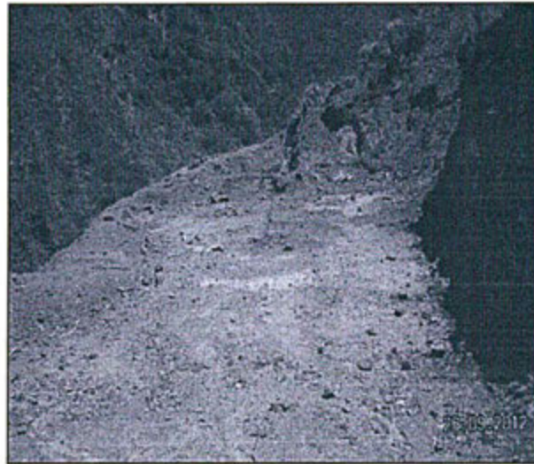
Foto 34: Vista de la plataforma de taladro de perforación SH12-PW2 sin remediar (Observación N° 2)
