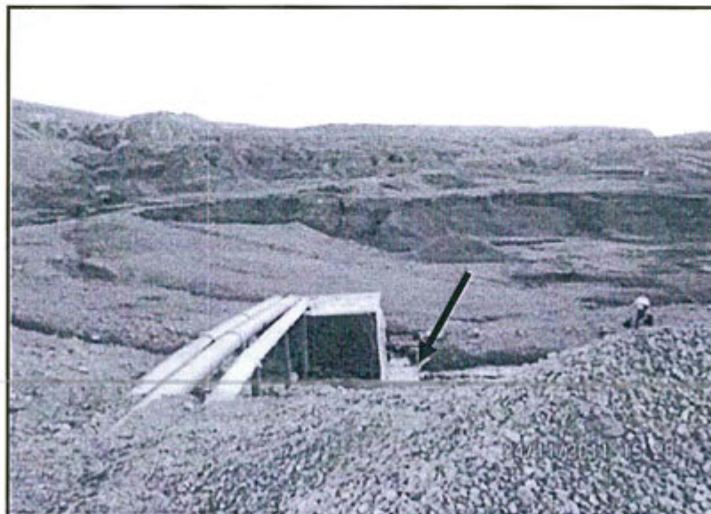
Fotografía N° 5. Rebose en la caja de concreto del agua de mina del Socavón Smelter, que escurre a la Laguna de Colección. Observación N° 2 (Continuación (b) Supervisión 2011. Observación N° 11 – Supervisión 2011).
