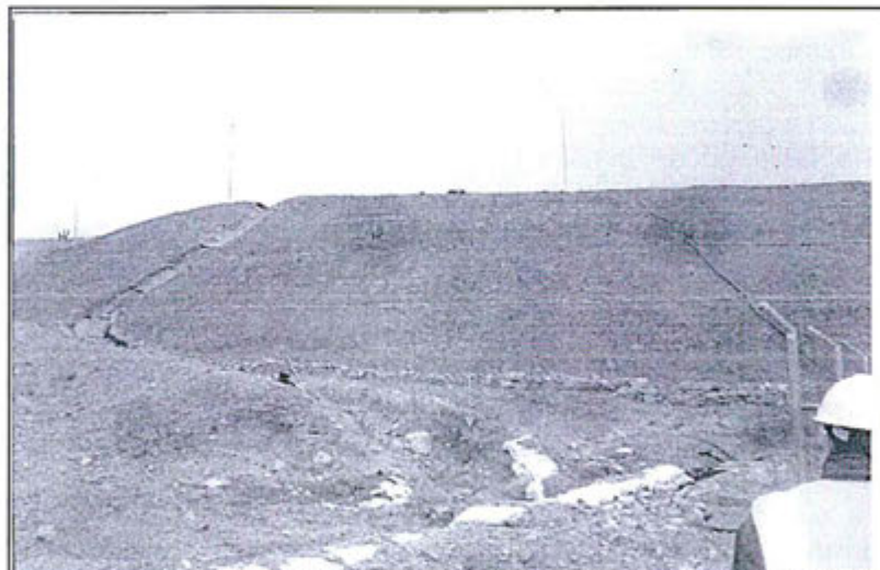
Fotografía N° 7.- Observación 2, supervisión 2011: Se observo que en el canal de drenaje de agua superficial de la poza SUMP N° 5 Etapa 10 - Pad Carachugo, se puede apreciar que dicho canal se encuentra erosionada en la parte baja de su recorrido siendo conformada por sacos rellenos como contención la cual se encuentra enterrada parte de ella.
