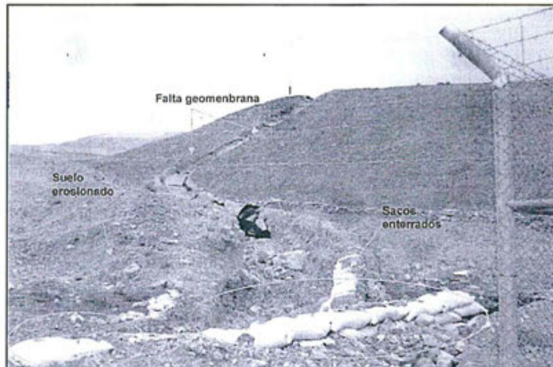
Fotografía N° 6.- Observación 2, supervisión 2011: Se observo que en el canal de drenaje de agua superficial de la poza SUMP N° 5 Etapa 10 - Pad Carachugo, algunas partes se encuentran sin geomembrana, así mismo se puede apreciar que dicho canal se encuentra erosionada en la parte baja de su recorrido.
