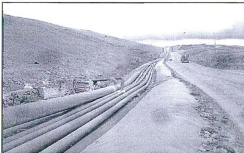
Fotografía N° 11.- Observación 3, supervisión 2011: Se puede apreciar las tuberías de conducción sostenidas con soportes construidos con sacos de material en mal estado.
