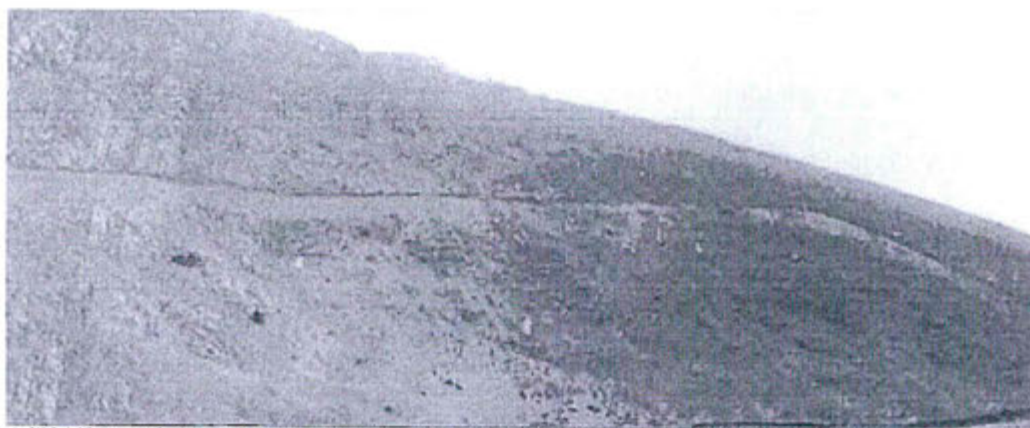
Foto N° 3.d. Vista panorámica del lado Sur de la Desmontera "Sansón", donde se observa el canal de coronación concluido al 100%
