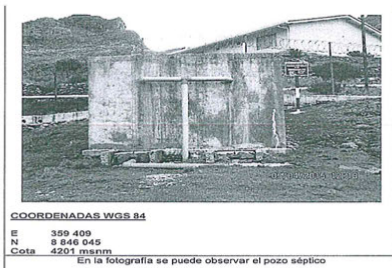
Imagen 06.- Tanque Séptico de la Empresa Explotadora de Vinchos
