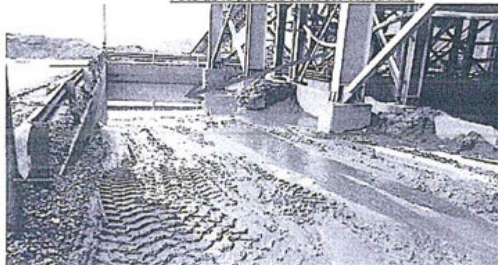
Imagen 7.- Sistema de contención de concreto para el manejo de agua de pebbles
