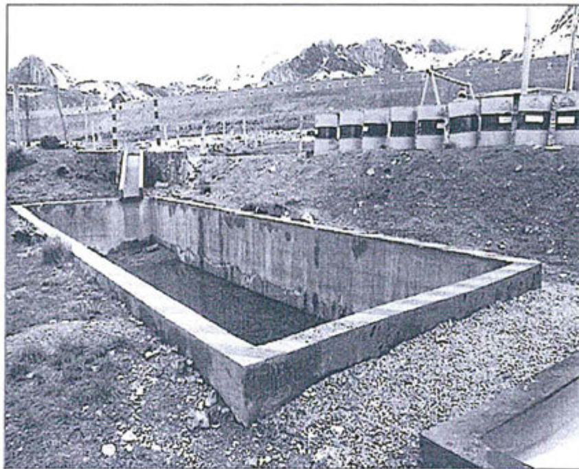
Fotografía N° 3: Se observa la poza construida para contingencia N° 2.
