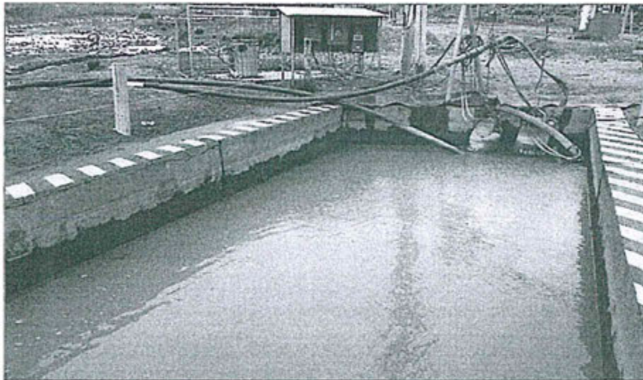
Fotografía N° 1: Se observa el sistema de bombeo automático instalado en la poza de colección N° 1. Ubicación de las bombas N° 1 y N° 2.
