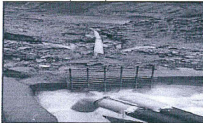
Fotografía 2: Segundo cajón colector desde donde las aguas son derivadas mediante tubería de alvenius de 8" fuera de la zona de desmontes. (Folio 1334)
