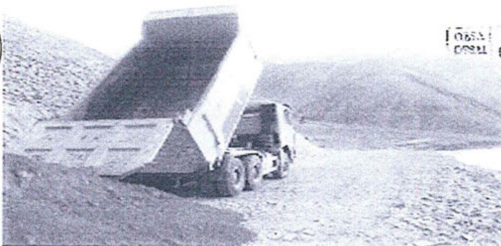
Relleno del canal de coronación y el canal de contingencia de tubería de relave.
