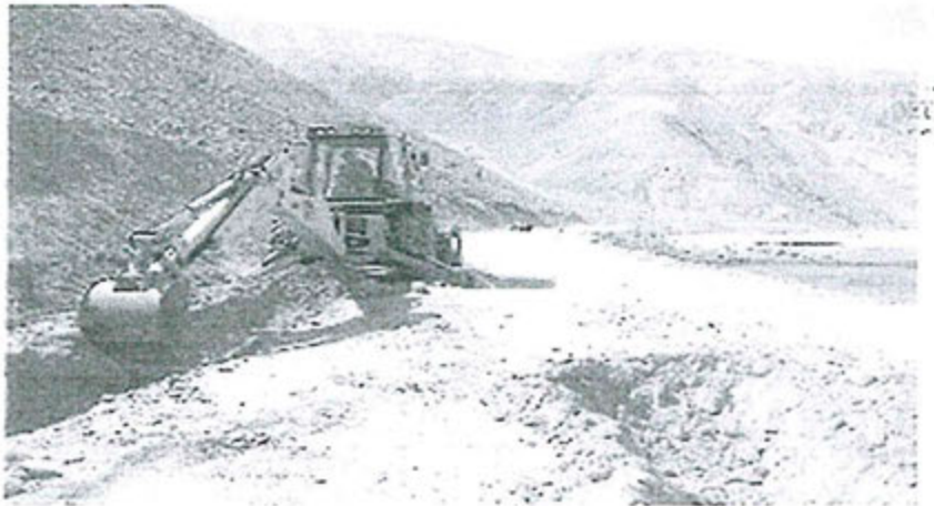
Resaltando la construcción del canal de coronación y del canal contingencia de Tubería de relave.
