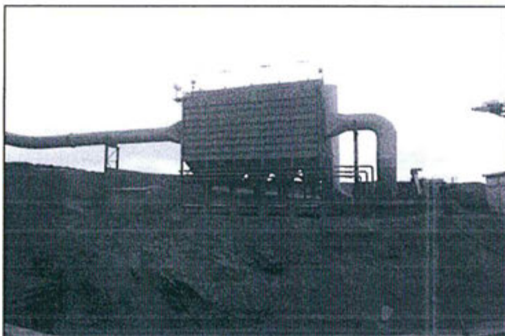
Fotografía N° 1: Colector de polvo planta de chancado N° 1
