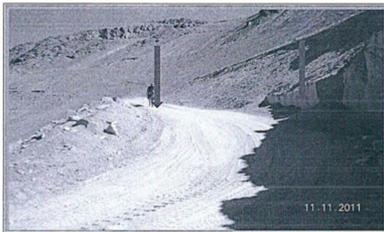
Fotografía N° 19: Las vías de acceso hacia la unidad minera no cuentan con las respectivas cunetas de drenaje como lo establece sus instrumentos de gestión ambiental, Recomendación N° 9, UEA Chaquelle 2011.
