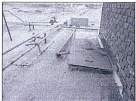
Caseta de Bombas de la Estación 151
