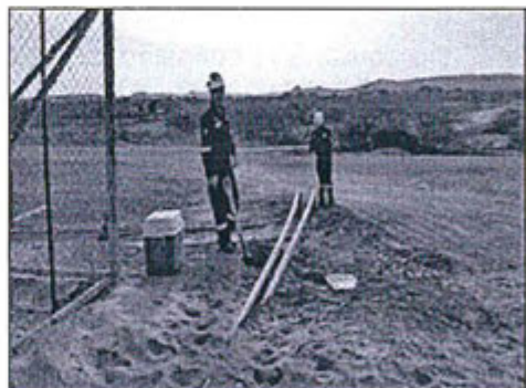
Área de tuberías Estación de bombeo 502
