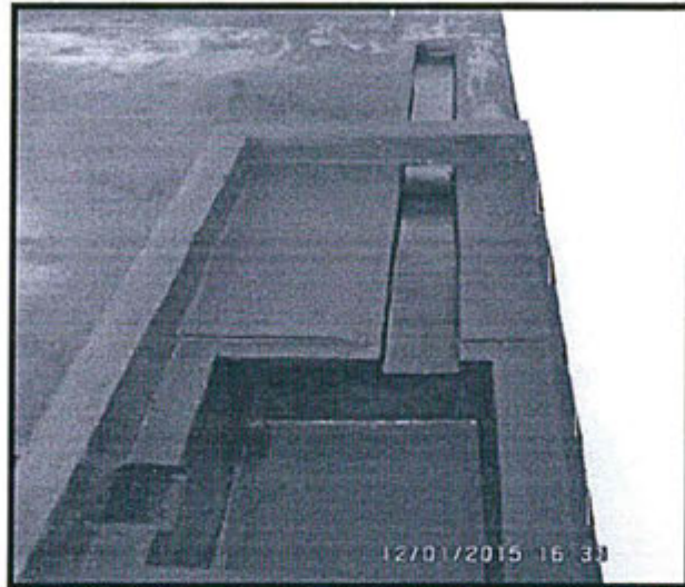
Poza de almacenamiento de lixiviados y tanque externo
