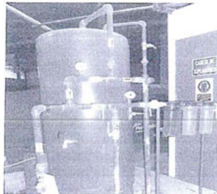
Ubicación e instalación de sistema de filtración a la salida del filtro de arena y grava de cuarzo
