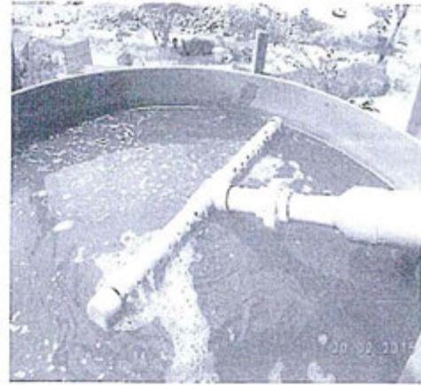
Acople de tubería de 2" con perforaciones de 8mm para el sistema de reposo de caudal de ingreso al tanque digestor de lodos
