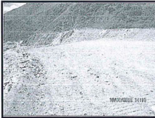
Vista 5: DME-1 falta reperfilar.
