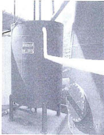
Tubería de salida: digestor de lodos al tanque de contacto
