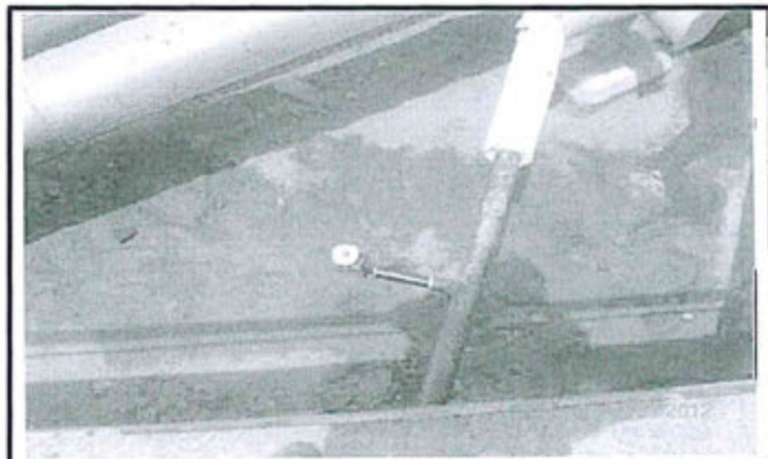
Fotografía N° 32: En las tuberías del Tanque N° 72, obsérvase aproximadamente 12 m 2 de suelos afectados con hidrocarburos.
