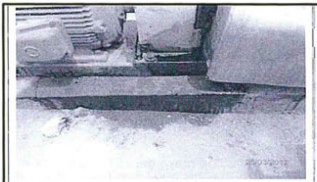
Fotografía N° 42: Altura del Tanque 3A (coordenadas UTM en WGS 84: 8644837N, 290774E), obsérvese suelos afectados con asfalto (hidrocarburos).
