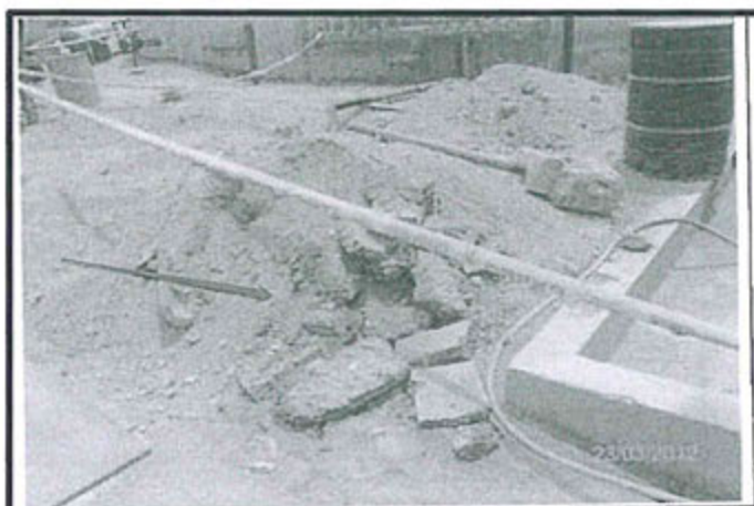
Fotografía N° 21: En la Línea de Ducto, obsérvese residuos dispersos (asfalto) al costado del camino frente al Tanque N° 46 (coordenadas UTM en WGS 84: 8644791N, 290908E).
