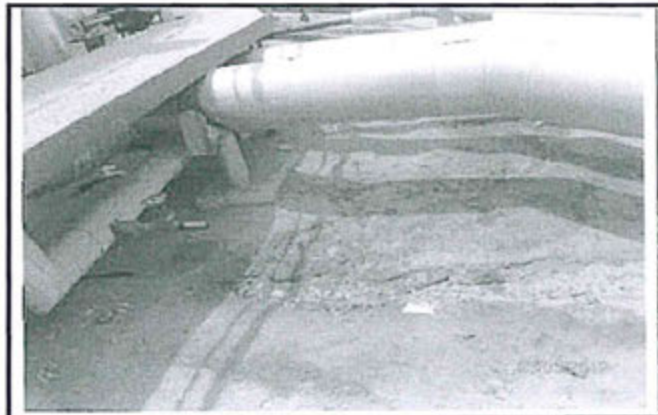
Fotografía N° 31: En las tuberías del Tanque N° 72, obsérvase aproximadamente 12 m 2 de suelos afectados con hidrocarburos.
