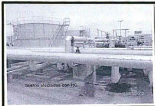
Fotografía N° 18: En la Línea de Ducto a la altura del Tanque N° 63, Vista de aproximadamente 1 m 2 de suelos afectados con hidrocarburos (coordenadas UTM en WGS 84: 8644778N, 290947E)
