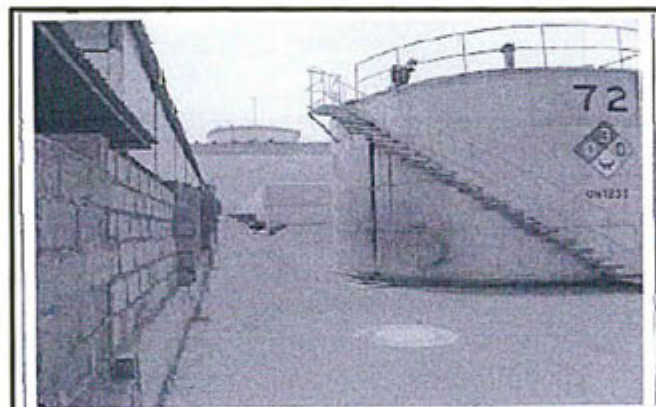
Fotografía N° 37: Vista panorámica de otra zona donde le falta completar el dique de contención de los tanques 72 y 36.
