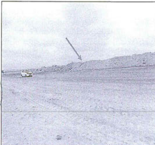
Fotografía N° 05: Berma de protección temporal interna Oeste (lado norte) construido con material estéril. Sirve de protección de una ocurrencia de aguas de escorrentías del FEN y protege el tajo, desmontes y demás componentes.
