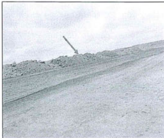
Fotografía N° 07: Berma de protección temporal interna Oeste (lado sur) construido con material estéril. Sirve de protección de una ocurrencia de aguas de escorrentías del FEN y protege el tajo, desmontes y demás componentes.
