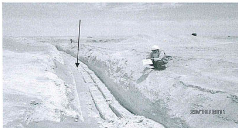
FOTO N° 2.13: Observación N 6. Canal de coronación de desmontes. Lado sur del área de desmontes.
