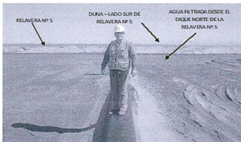
Foto N° 2.9. Filtraciones de agua clarificada a través de los diques de la poza de relaves N° 5, de su lado norte, colindante al acceso que conduce a la poza de relaves N° 1, en construcción. Esta agua se ubica en el sector por donde pasa la tubería de HDPE con el relave fino desde la planta de concentrado. Es contenida en una parte por un segundo dique paralelo. Este sector que contiene el agua filtrada está entre la presa de relaves y el acceso.
