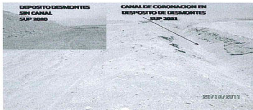
FOTO N° 2.12: Observación N 6 - Regular 2010. Canal de coronación. Estos canales son recto ubicados en el lado norte y sur de las áreas de desmontes. Pendientes dirigidas hacia el cauce natural del agua. Es necesario practicar su mantenimiento periódico para evitar su colmatación.
