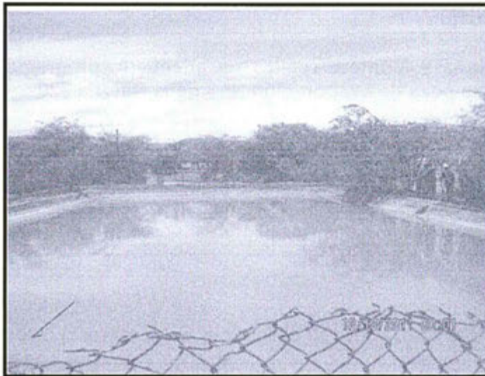
Fotografía N° 12: Poza de Evaporación N° 3 en Batería 320 de donde filtra agua de producción.
