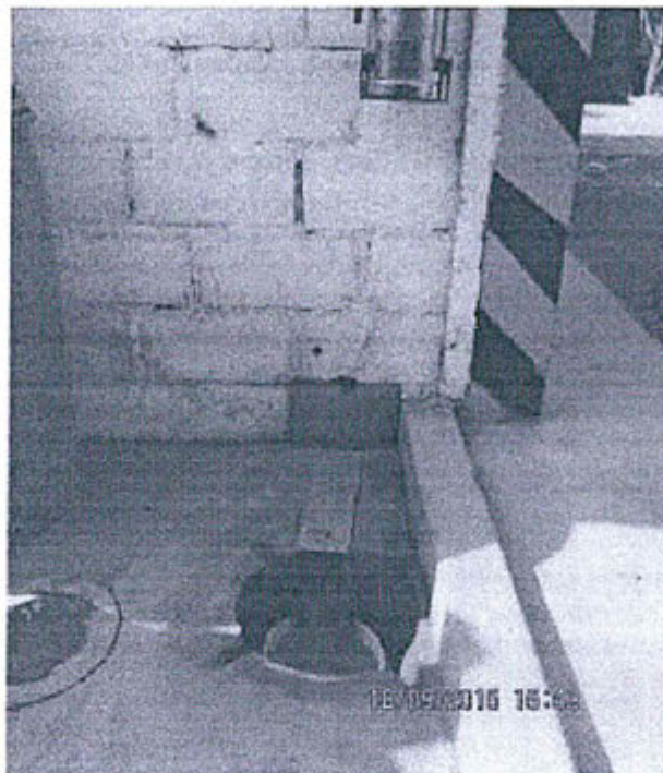
Fotografía 5: Depósitos de Lixiviados (Folio 155)
