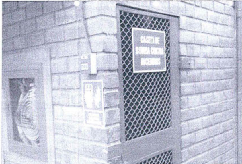
Imagen 2. Sistema contra incendios "Caseta de Bomba contra Incendios" ubicado frente al Almacén Temporal de Residuos Peligrosos
