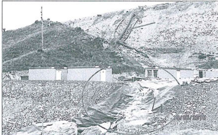
Imagen 5. Estado actual de la Quebrada observada – con geomembrana (Coordenadas UTM 275890E 8942472N, DATUM WGS84)
