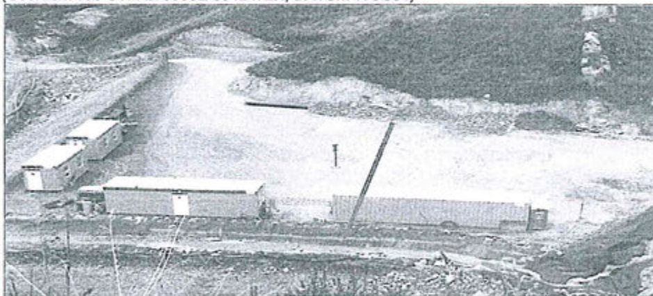
Imagen 6. Estado actual de la parte baja de la Quebrada observada – menor flujo (Coordenadas UTM 275930E 8942472N, DATUM WGS84)
