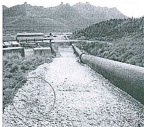
DESPUÉS: Vista del área luego de la limpieza y de la tubería luego de su reparación y sustitución.
