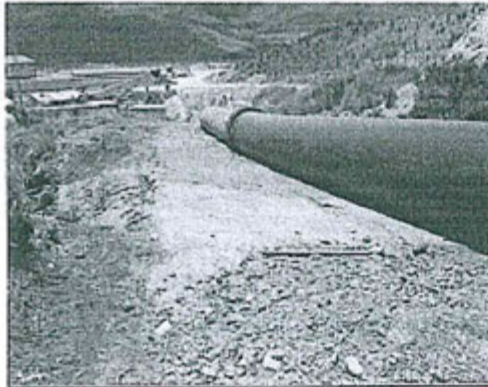
ANTES: Vista del derrame de relaves sobre la plataforma elaborada con material de préstamo.
