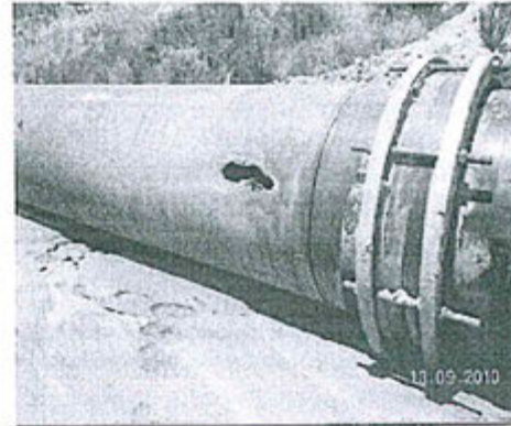
ANTES: Vista del agujero en la tubería de HDPE por donde se habría derramado el relave.
