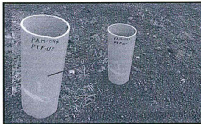
Fotografía N° 42. Hallazgo N° 3 Sondaje de Perforación Diamantina PAM-047. Vista fotográfica de la tubería insertada al sondaje diamantino PAM-047, ubicado en la Plataforma de Perforación PTF-110.
