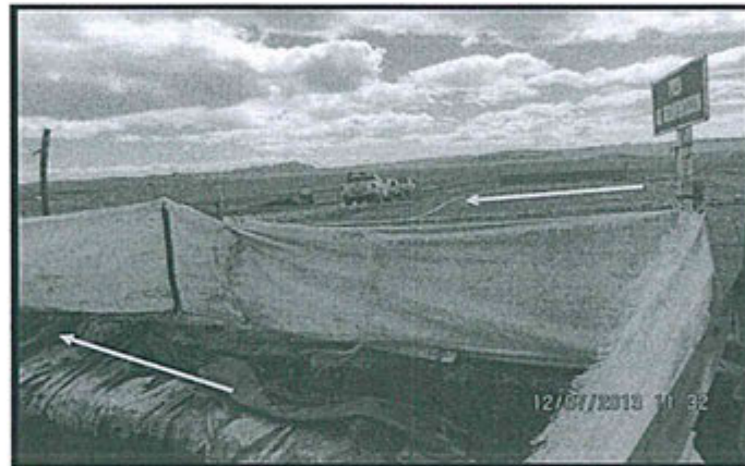
Fotografía N° 27: Hallazgo N° 1 Plataforma de Perforación PTF 056. En la supervisión se constató la existencia de una tubería de 4" de diámetro, utilizada para el bombeo de lodos de la poza de lodos de la plataforma de perforación PTF-056 a la poza de lodos de la plataforma de perforación PTF-128.
