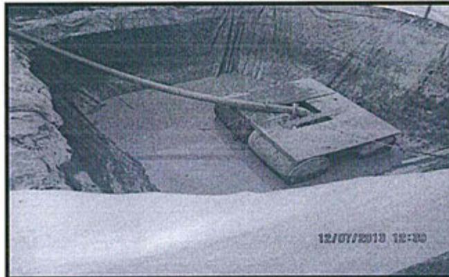
Fotografía N° 30: Hallazgo N° 1 Plataforma de Perforación PTF 056. En la poza de lodos se constató la existencia de una bomba sumergible con su tubería respectiva para el bombeo de lodos a la poza de lodos de la plataforma de perforación PTF-128.
