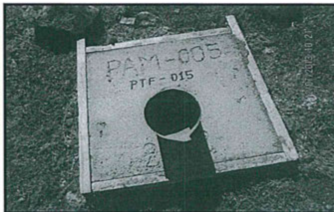
Fotografía N° 40. Hallazgo N° 3 Sondaje de Perforación Diamantina PAM-005. Vista fotográfica del dado de concreto del sondaje diamantino PAM-005. Se constató que la boca del sondaje no está sellado.
