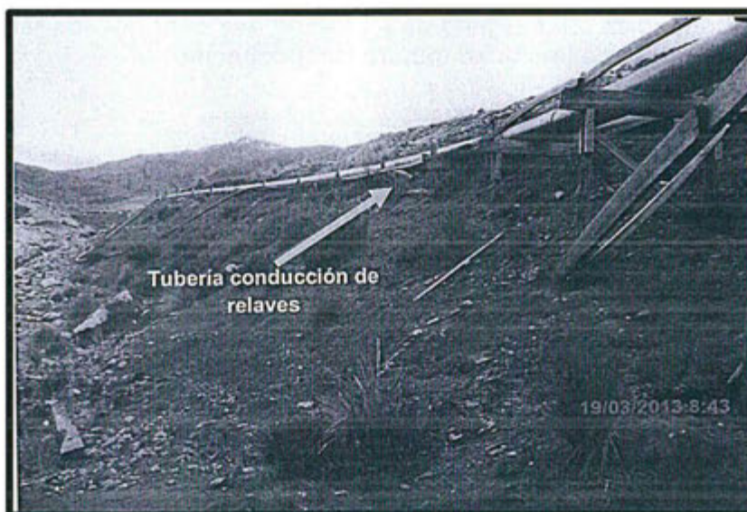
Fotografía N° 41: Tubería de conducción de relaves sin sistema de contención para derrames
