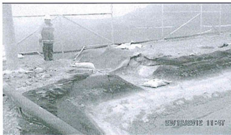
Foto 84: Observación N° 13-2012, Vista de la Poza N° 5, se aprecia un vertedero, al momento de la supervisión no se evidenció caudal de descarga, la poza no contaba con una base impermeabilizada.
