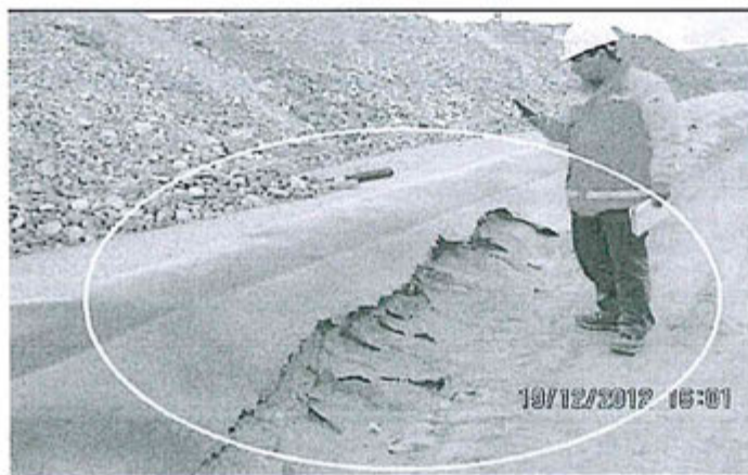
Foto N° 74: Observación N° 08-2012, en el área del Pad de Lixiviación se verificó que la berma de seguridad se encuentra en estado de deterioro en varios tramos.
