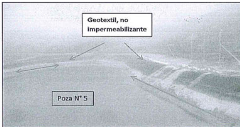
Foto N° 83: Observación N° 13-2012, Vista de la Poza N° 5, ubicada en las coordenadas UTM datum WGS84: E 732552, N 9244991, el cual cumple la función de captar aguas de escorrentía y no cuenta con una base impermeabilizada.
