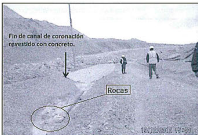
Fotografía N° 71: Observación N° 07-2012, área del Pad de Lixiviación, se verificó que parte del canal de coronación cuenta con base y/o cobertura de concreto y otra parte no.
