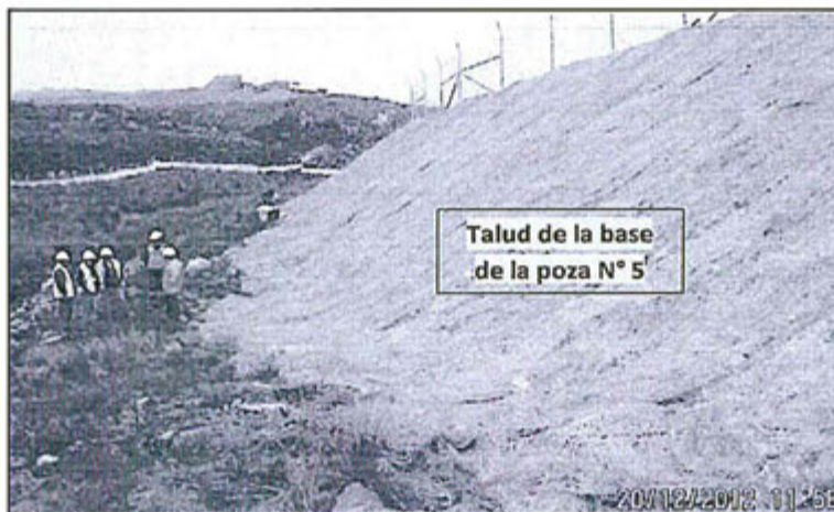
Foto N° 85: Observación N° 14 – 2012, en el talud de la poza N° 05, se encontró afloramiento de aguas, sin conocimiento de la procedencia por parte del titular minero.
