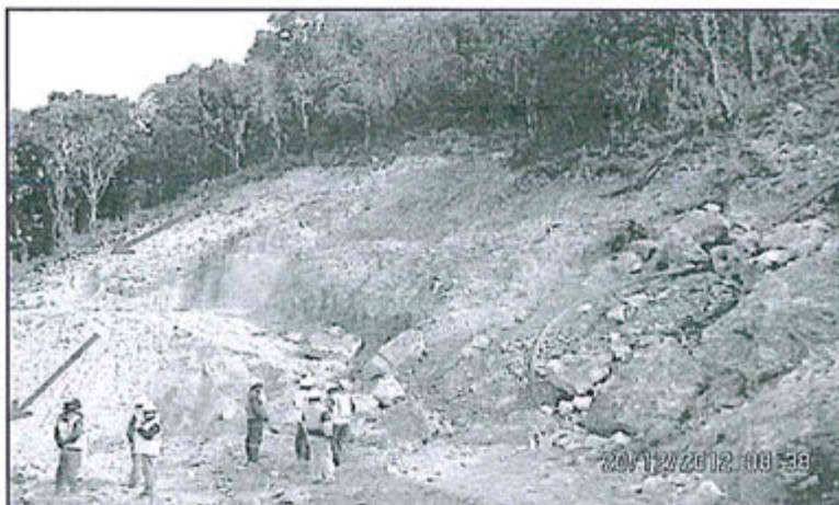
Foto N° 76: Observación N° 09-2012, área del talud del Tajo San Pedro Sur, se evidenció arrastre de material, generado por la remoción de suelo.
