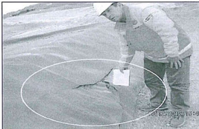
Foto N° 73: Observación N° 08-2012, en el área del Pad de Lixiviación se verificó que la berma de seguridad se encontraba en estado de deterioro en varios tramos.
