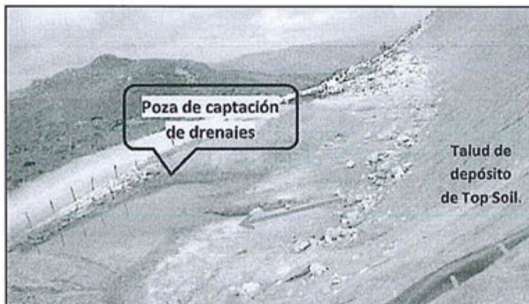
Foto N° 81: Observación N° 12-2012, en el depósito de top soil se verificó la existencia de una poza de captación de drenaje del depósito de top soil, la cual no cuenta con bases impermeabilizadas que evite las filtraciones sobre el suelo.
