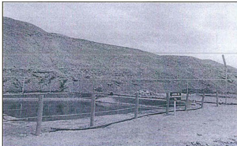
Fotografía N° 25.- Poza de oxidación de la planta de tratamiento de aguas residuales domésticas.
