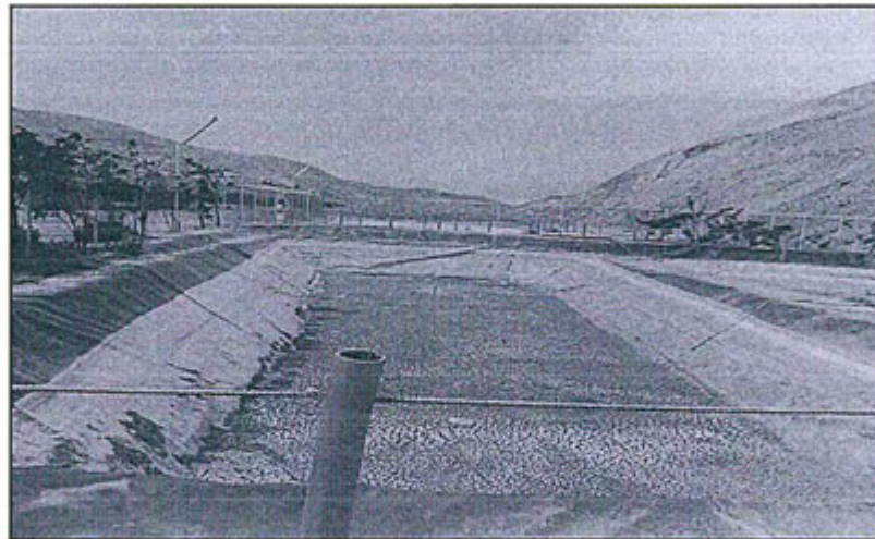
Fotografía N° 24.- Poza de lodos de la planta de tratamiento de aguas residuales domésticas; la huella indica que el agua estuvo en un nivel superior y se encuentra en proceso de secado.
