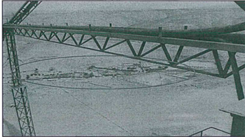
Fotografía N° 46.- Tubería de conducción de relaves instalada directamente sobre elementos de fierro que de producirse un derrame éste se conduce hacia la quebrada emplazada al fondo (círculo rojo).
