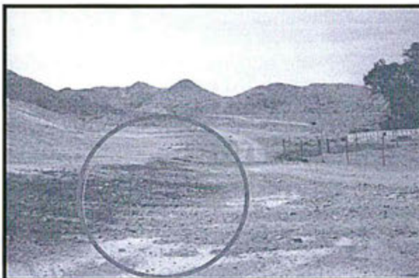
Foto N° 22: Talud de poza N° 3: Los relaves habían invadido un tramo de la carretera, por lo que se dejó la Recomendación: implementar un muro de contención al pie del talud del depósito de relaves N° 3 para un mejor manejo de la disposición de relaves.
