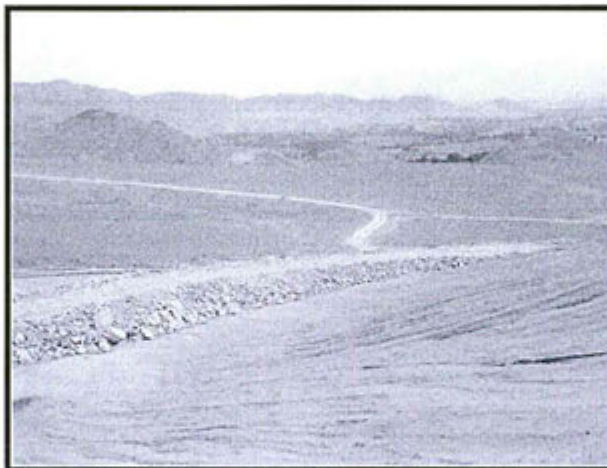
Vista general hacia el este del muro de desmonte que se está implementándose encima de la ya existente
