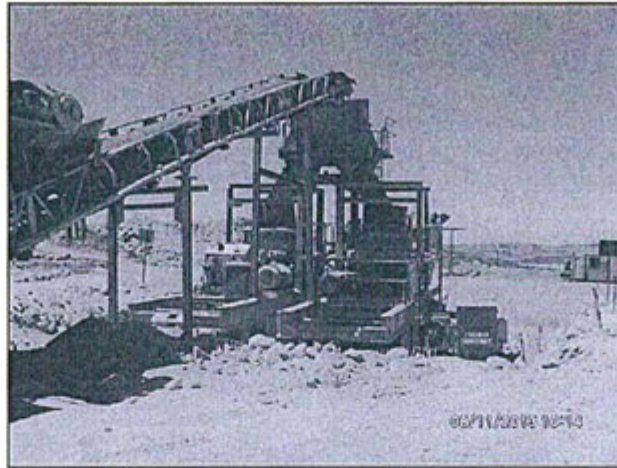
Fotografía N° 125 del Informe de Supervisión: Hallazgo 3 – Planta Móvil de Chancado; dos chancadoras secundarias giratorias.
