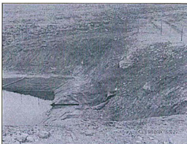
Fotografía N° 121 del Informe de Supervisión: Hallazgo 1 – Punto de ingreso de las aguas provenientes del sistema de subdrenaje del depósito de desmontes N° 1.
