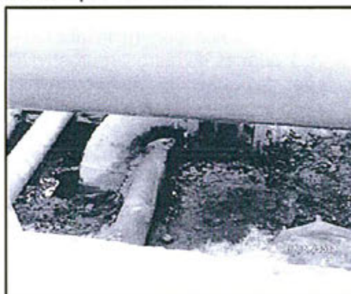
Fotografía N° 2: Vista con mayor detalle que evidencia la presencia de hidrocarburos debajo del rack de tuberías de servicios industriales lado sureste, frente al tópic, en un área aprox. de 3 x 8 m.
