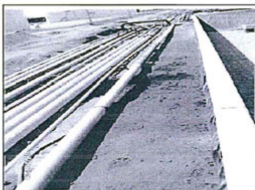
Fotografía N° 4: Tierra impregnada con hidrocarburos en un área aproximada de 8 x 2 m debajo del rack de tubería, ubicada al lado Oeste del Tanque 545.
