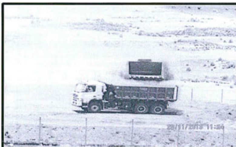
Fotografía N° 80.- Vista del carguío de top soil , se observa que se produce liberación de material particulado al ambiente.
