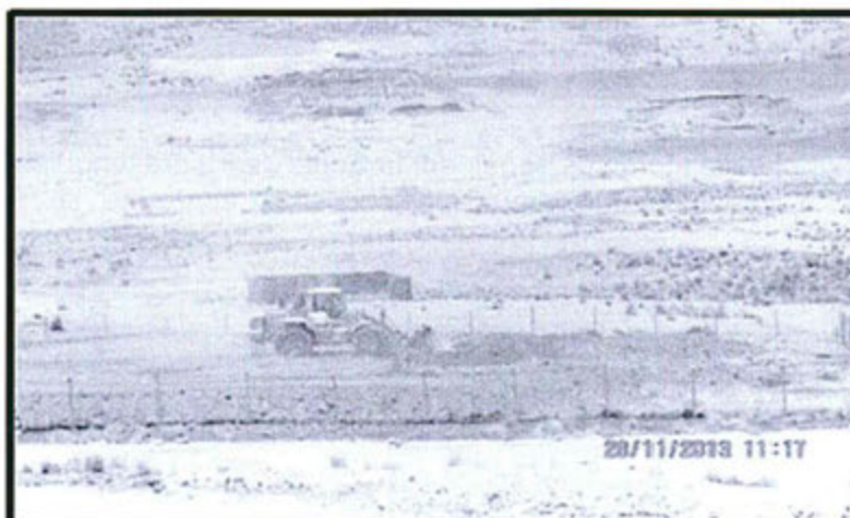
Fotografía N° 79.- Vista del apilamiento del suelo orgánico en la cancha de almacenamiento de top soil . Se observa que se está produciendo liberación de material particulado.
