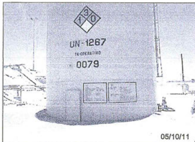
Fotografía N° 18: Se observa tanque operativo de 1500 Bls de cap. para crudo sin estanca impermeabilizada aledaño a la estanca del tanque 0078, en la Batería Carrizo con posición E: 480129 N: 9514926 Zona 17
